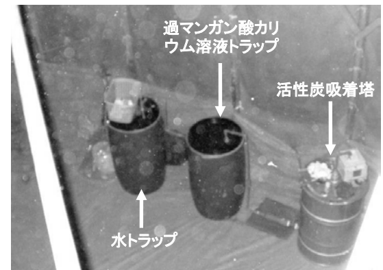
写真-4 水銀除去装置
