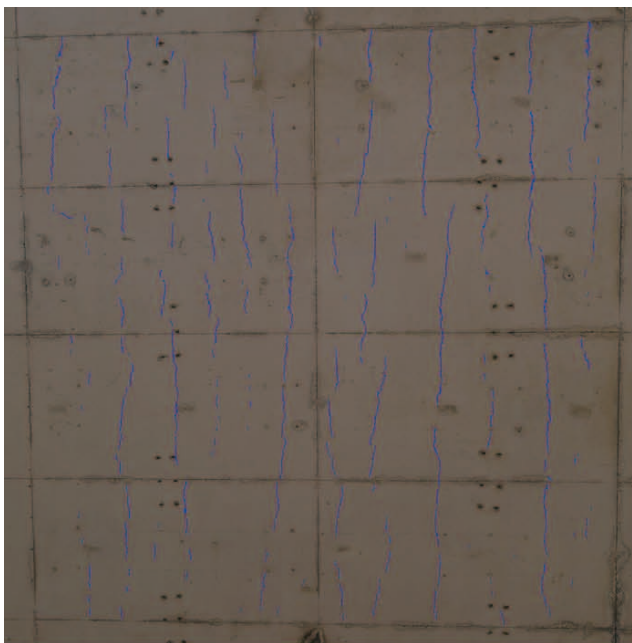
(a) 抽出したひび割れ分布図 (分解能 1.05mm)
