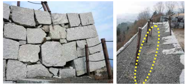
写真-9 地点Bの石垣の変状
