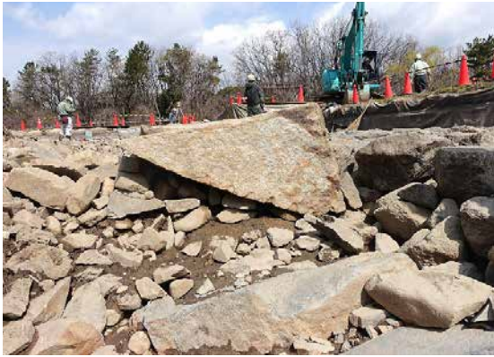
写真-4 城郭石垣における逆石の例
