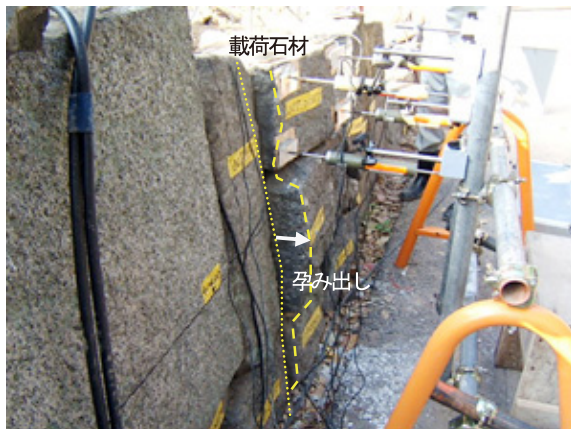
写真-3 載荷実験による孕み出し状況
