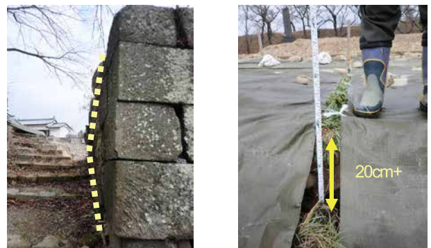
写真-10 地点Cの石垣の変状
