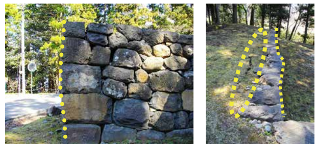
写真-8 地点Aの石垣の変状(左)と天端の陥没と地割れ(右)
