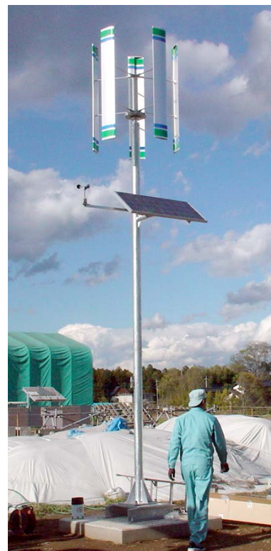
写真-1 小型風力・太陽光ハイブリッド発電システム
