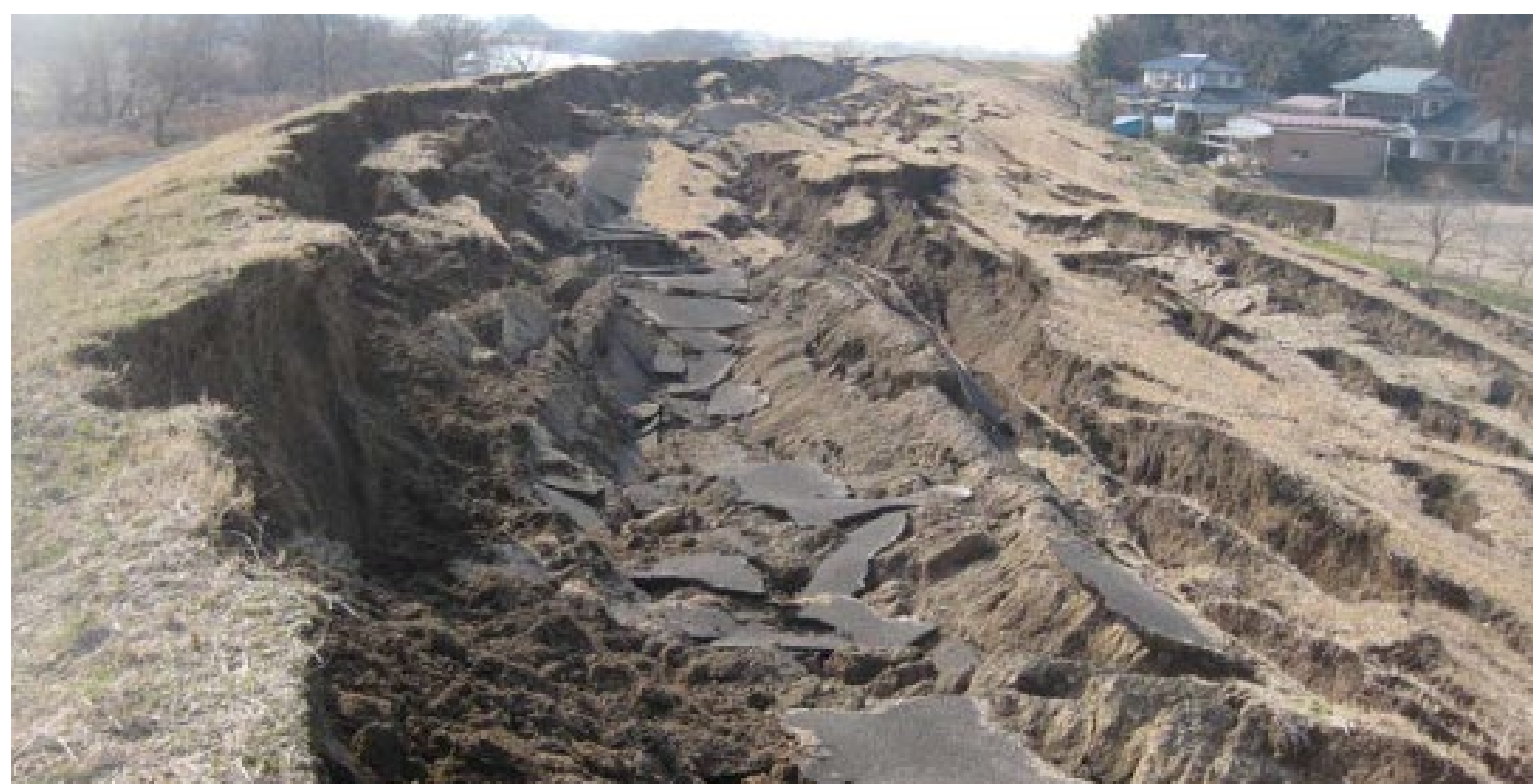
堤防地震被害 (東北地方整備局)
