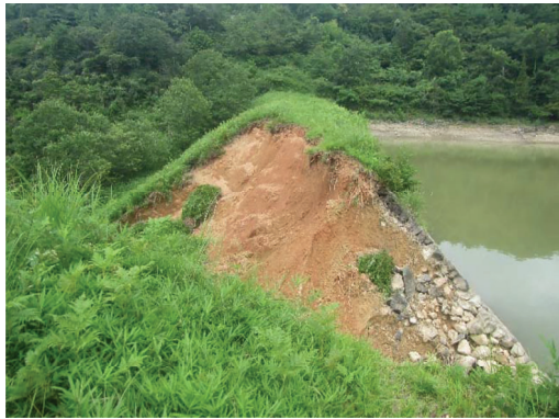
ため池豪雨被害(大田池、岡山県) 出典：平成30年7月豪雨災害ため池被災調査 報告書(速報)、農研機構
