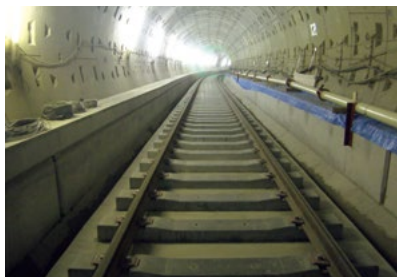
仙台市高速鉄道東西線 荒井トンネル工区土木工事(鉄道) 外径φ5,400mm×厚さ280mm×幅1,200mm 宮城県
