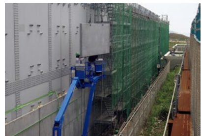
浜岡原子力発電所(防波壁防食パネル) 静岡県
