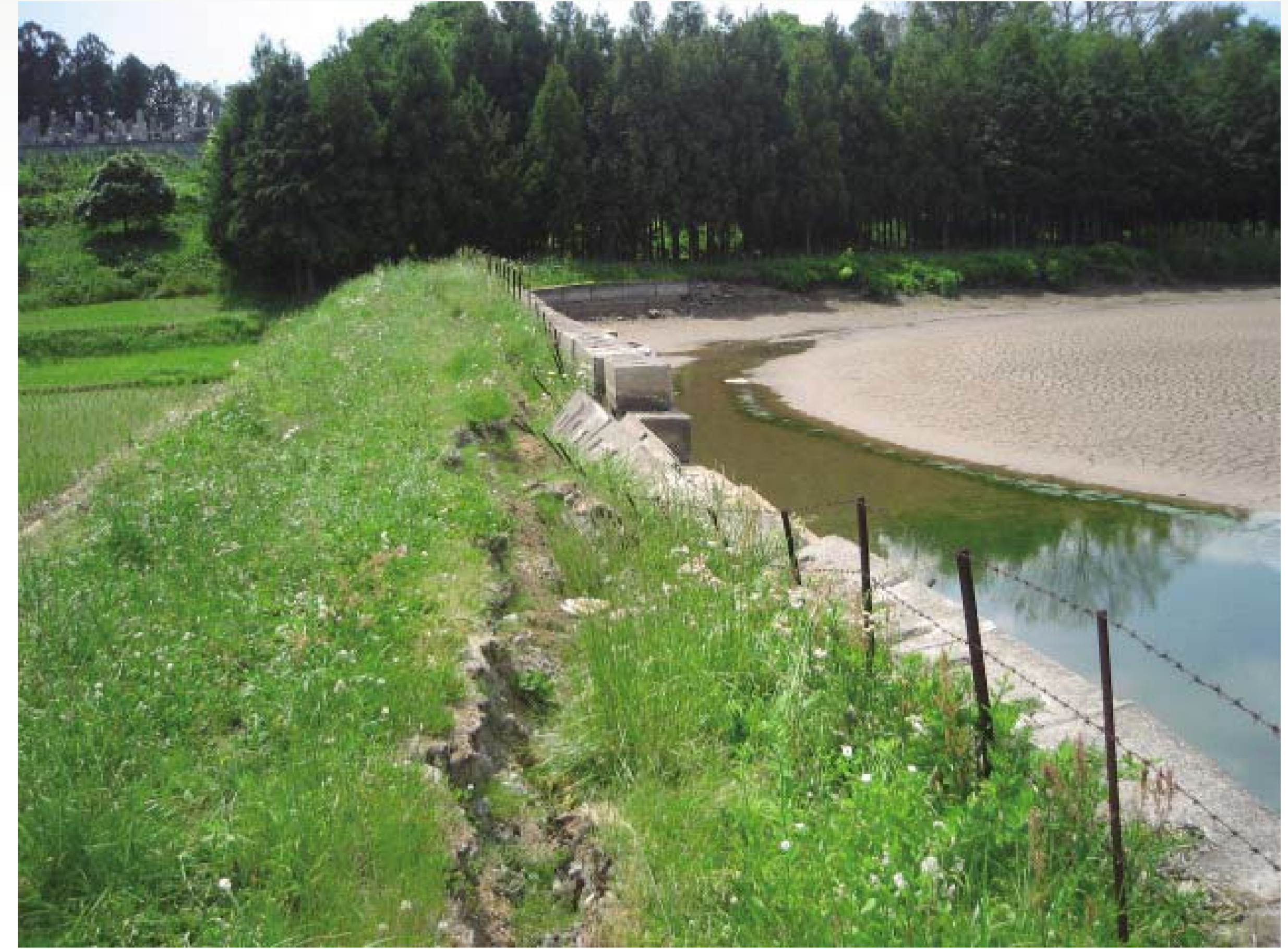
ため池地震被害（堂前池、福島県）
