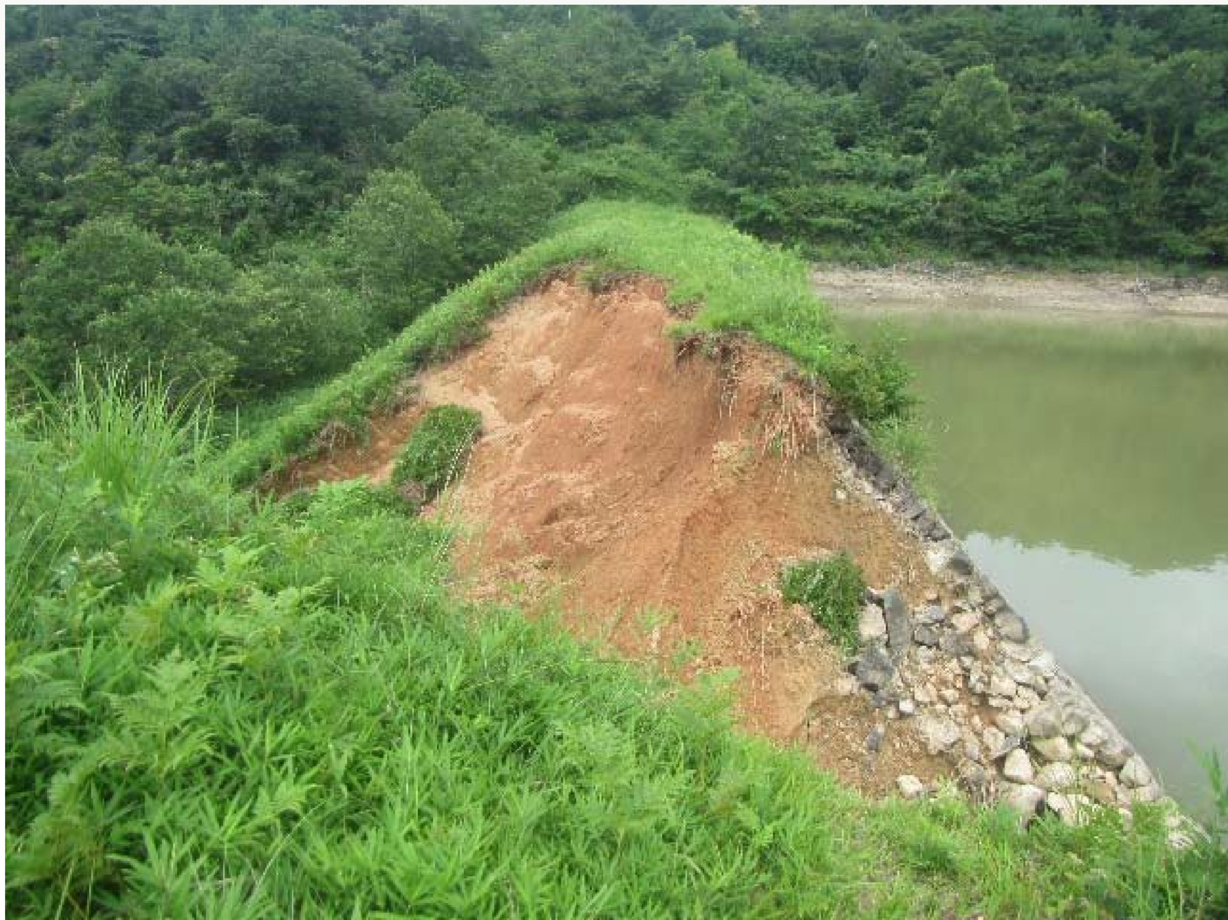
ため池豪雨被害（大田池、岡山県）
