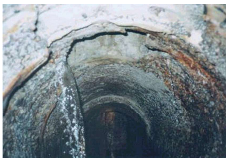
腐食箇所から地下水や土砂が流入します。
