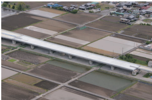
工事名：西脇北バイパス津万高架橋（P29-P35）PC上部工事 発注者：近畿地方整備局
