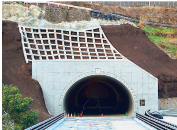
工事名：平成25年度 佐久間道路佐久間第2トンネル工事 発注者：国土交通省中部地方整備局
