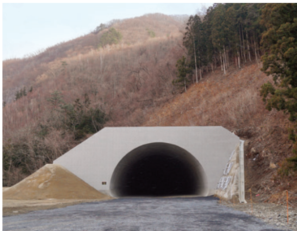
工事名：国道106号 箱石地区道路工事 発注者：国土交通省東北地方整備局
