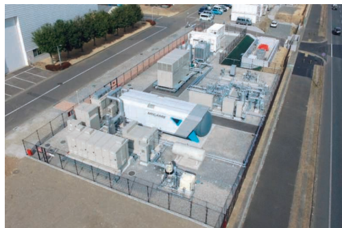
次世代型省CO 2 コージェネレーションプラント
