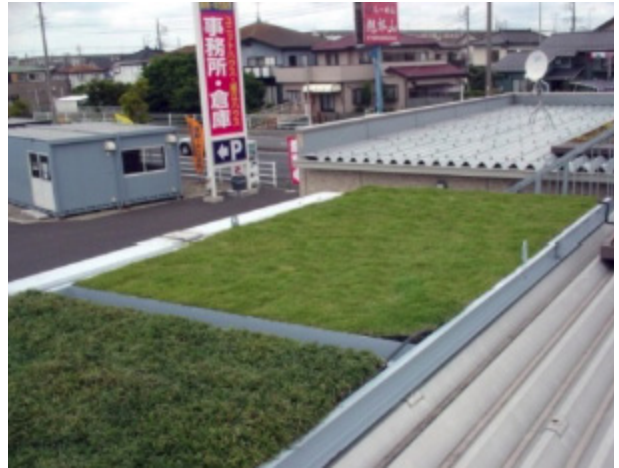
写真－10 屋上緑化システム
