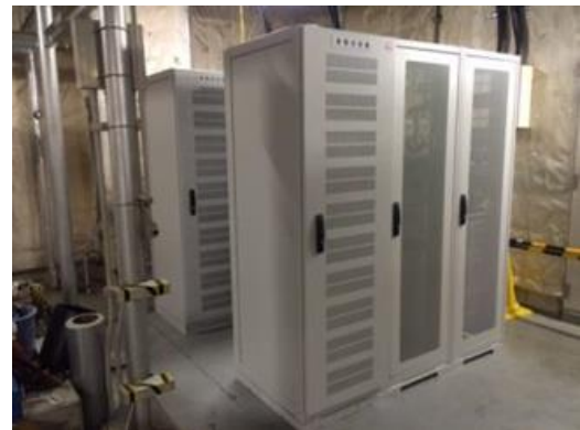
写真-3 蓄電池・電力変換装置設置状況
