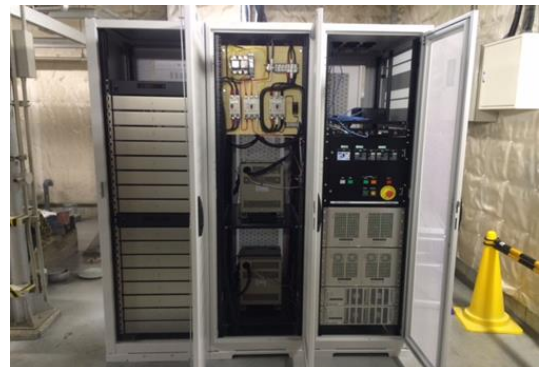
写真-4 蓄電池・電力変換装置設置状況
