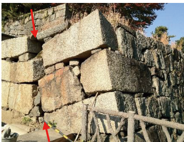
写真-4 縦目地の連続した石垣
