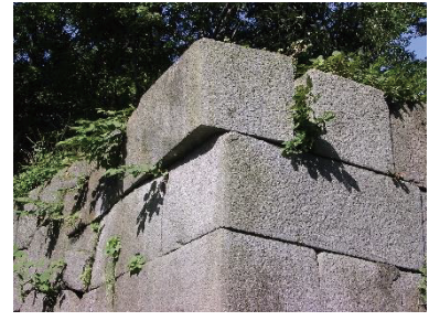
写真-9 天端石の変位
