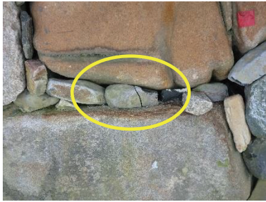
写真-7 地震により割れた間詰石
