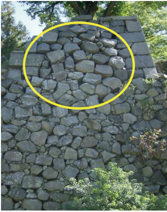
写真-1 石垣上部の孕み出し
