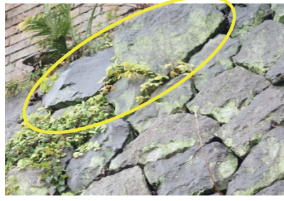
写真-8 植物により押し出された築石
