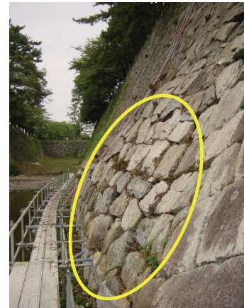
写真-3 石垣下部の孕み出し
