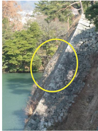
写真-2 石垣中央部の孕み出し
