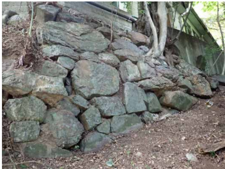
写真-10 樹木による石垣の変形
