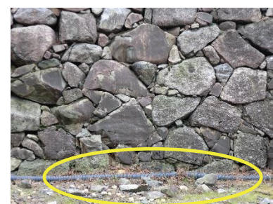
写真-6 抜け落ちた間詰石
