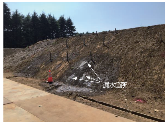
写真 5.2 湛水試験時の法面の状況 (無対策)
