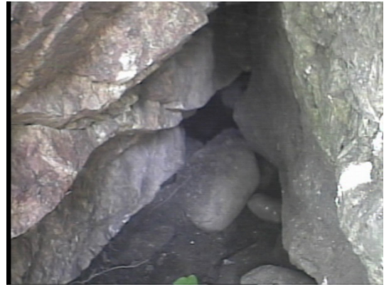
写真-5 ファイバースコープによる観察画像 築石背面に空隙が存在していることが確認できる
