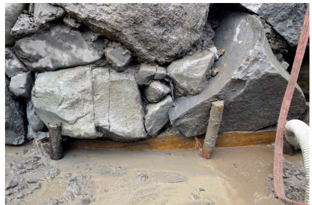
写真－1 石垣下部に出現した胴木の事例
