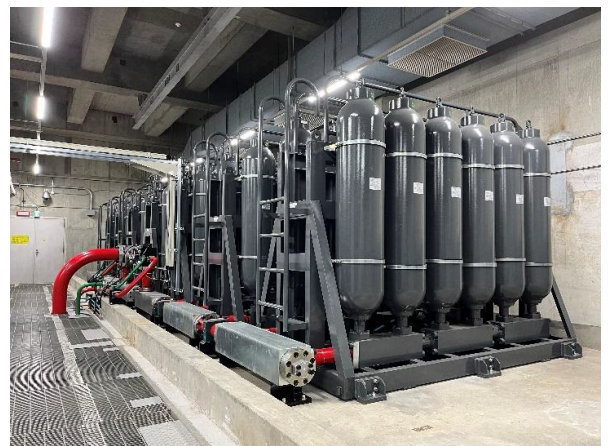
写真-3 アキュムレータバンク（7台）
