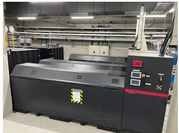
写真-2 ポンプユニット（3台）
