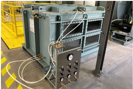
写真－6 真空脱気槽
