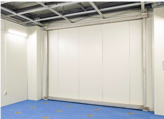
写真－３ ブランクパネル（屋内環境試験室側）
