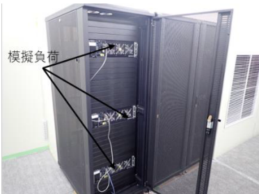
写真-4 サーバーラックおよび模擬負荷
