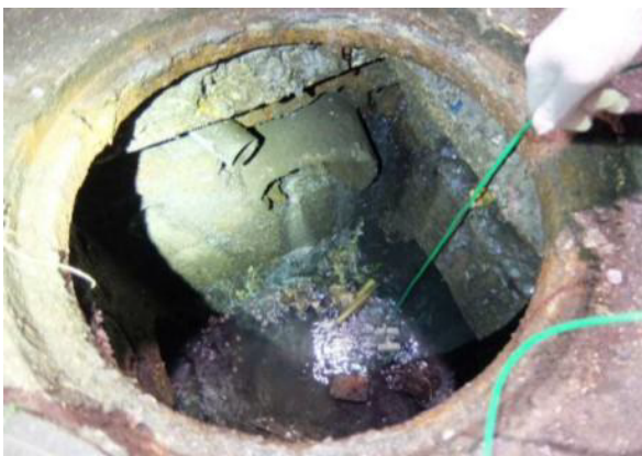
写真－7 既設マンホール（G3）腐食状況
