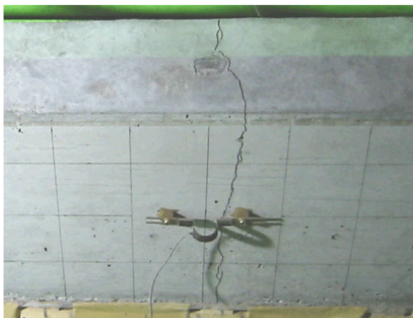
写真1 ひび割れ発生状況 (No. 7試験体)
